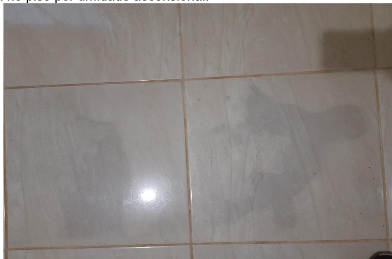
Figura 8 - Mancha no piso por umidade ascensional.
