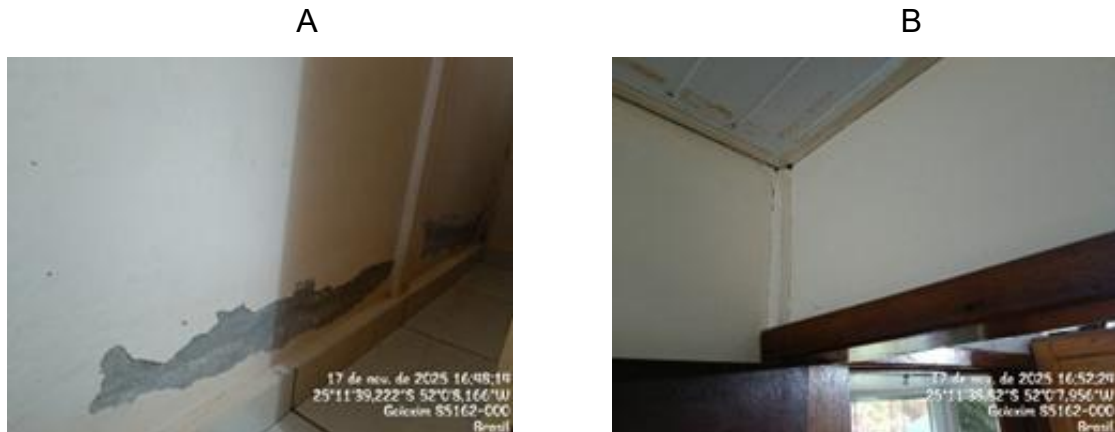
Figuras A e B – Exemplos de manifestações patológicas na Edificação 3
