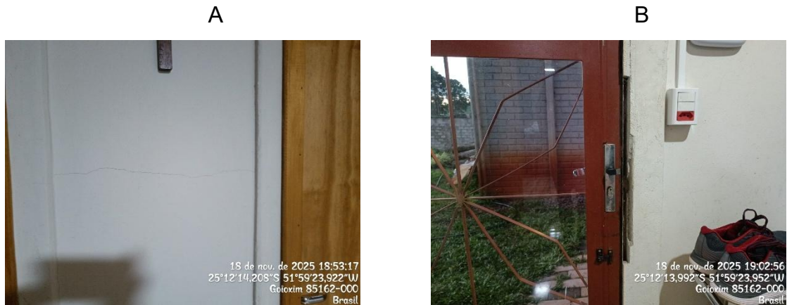
Figura A e B – Exemplos de manifestações patológicas da Edificação 4
