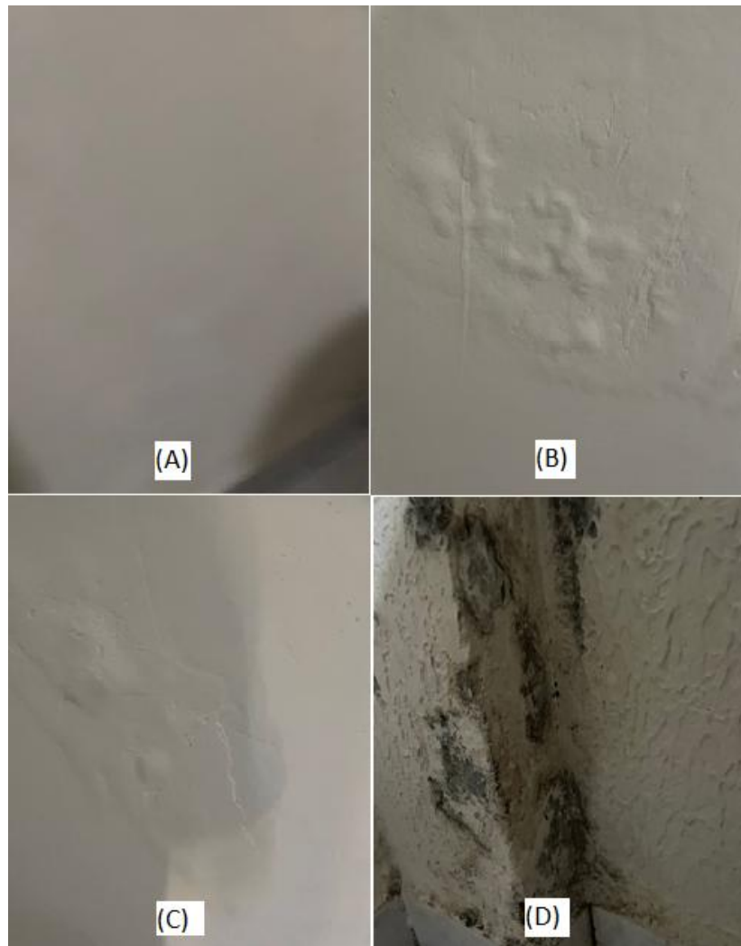
Figura 4 - Manifestações patológicas observadas na Escola 3 – (A), (B) E (C) Umidade, (D) Mofo.
