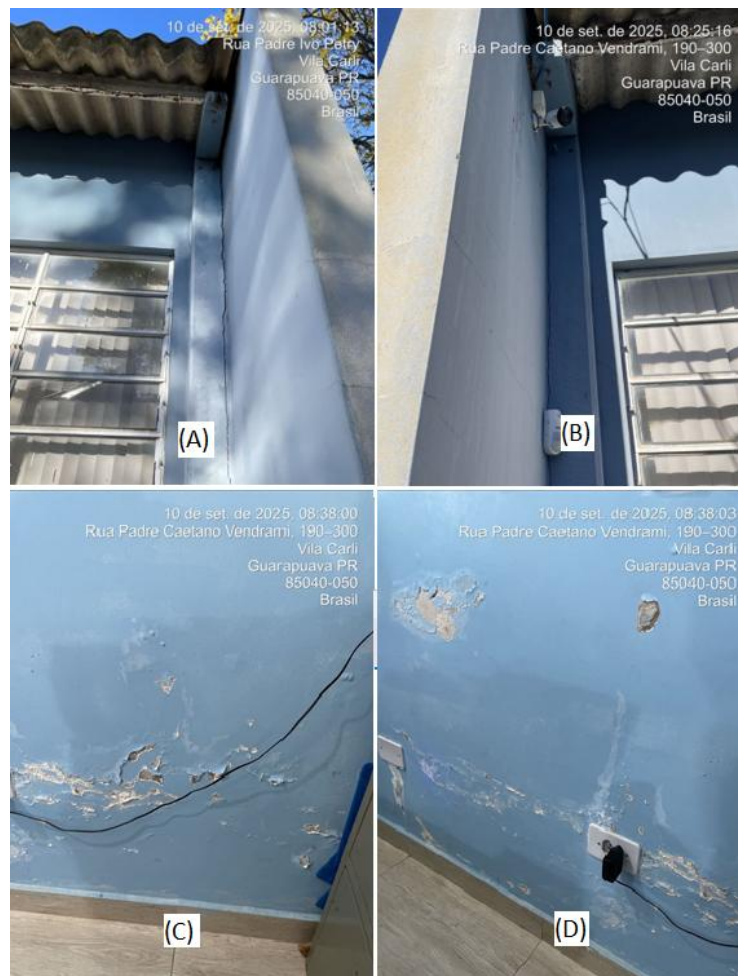
Figura 2 - Manifestações patológicas Escola 1 – (A) e (B) Trincas e (C) e (D) Umidade
