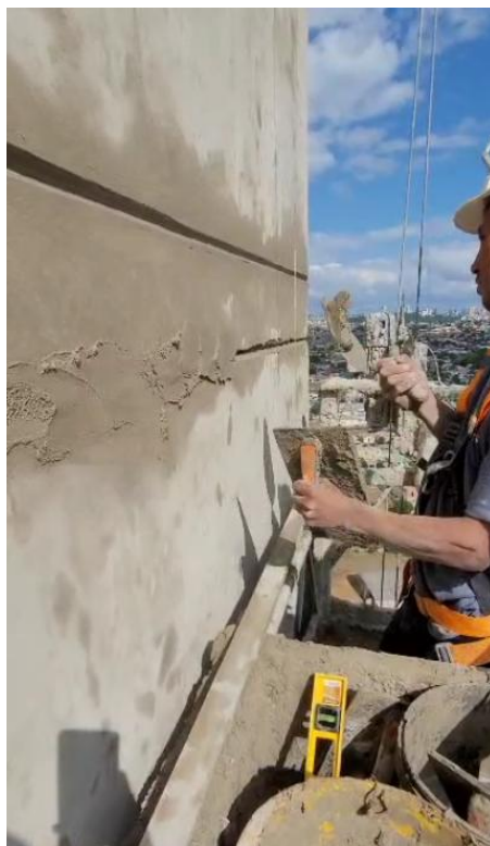
Figura 8 – Inspeção visual tradicional da execução das primeiras juntas de movimentação na prumada 1.
