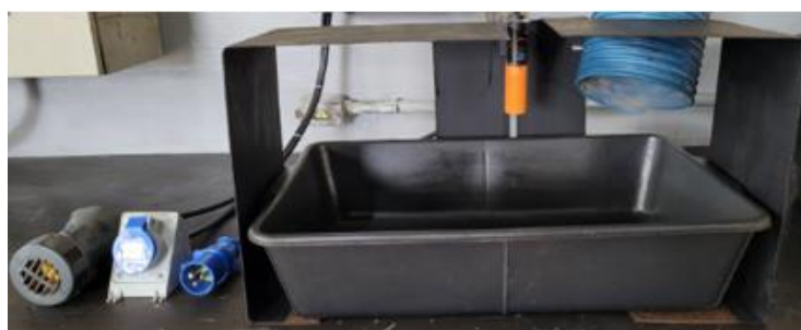
Figura 16 - Teste de acionamento do sensor de nível.
