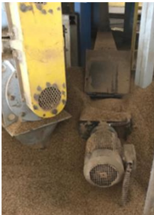
Figura 9 – Equipamento coberto por sujeiras ocasionado pelo transbordo.
