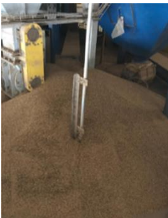
Figura 8 – Equipamento coberto por sujeiras ocasionado pelo transbordo.
