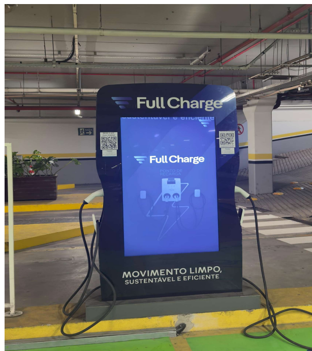
Figura 1 - Estação de carregamento rápido em funcionamento em shopping na cidade de Jaraguá do Sul-SC
