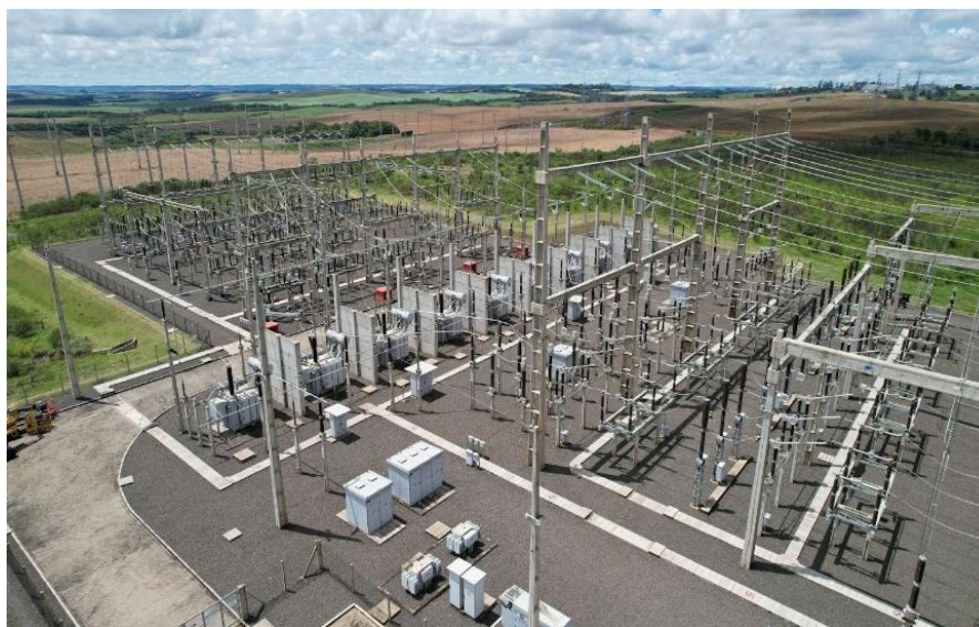
Figura 1 - Subestação Guarapuava Oeste 230/138 kV
