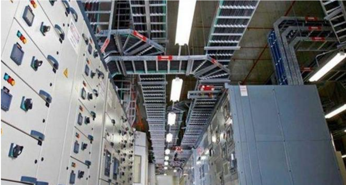
Figura 5 – Infraestruturas Elétricas Industriais
