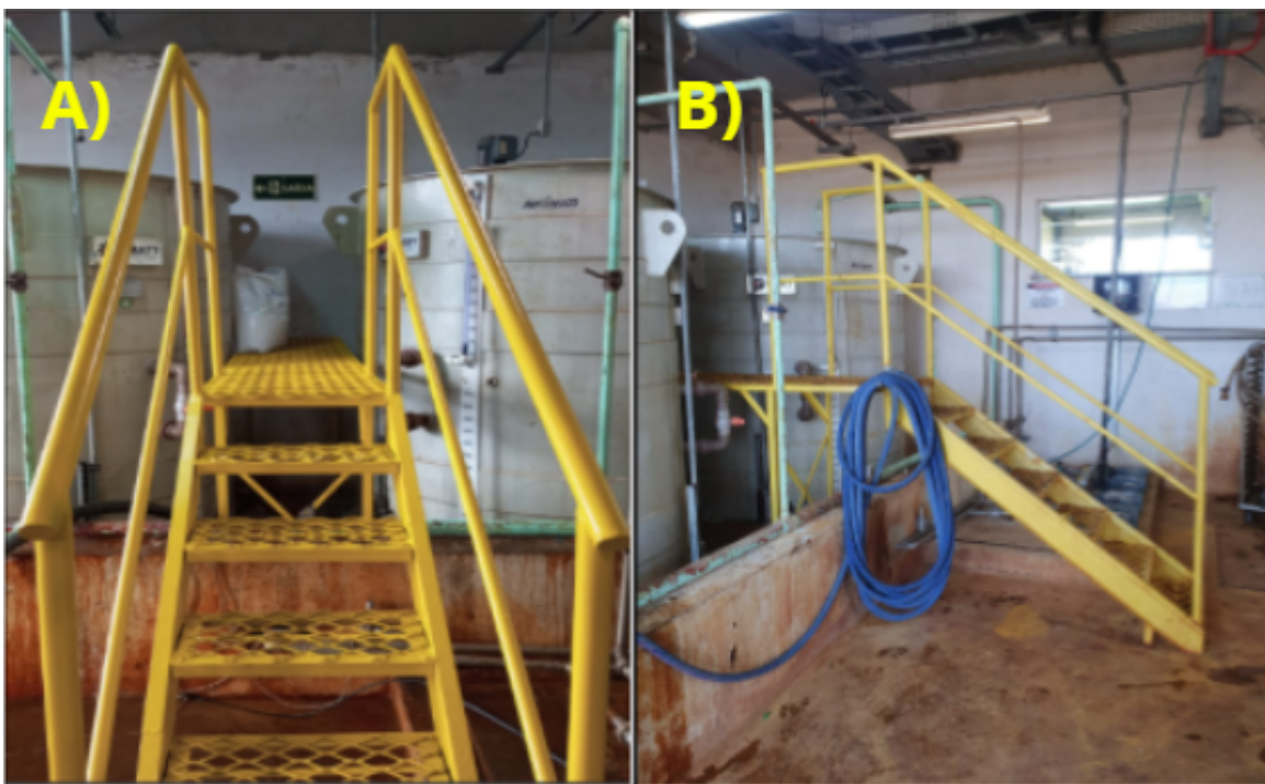
Figura 11 – Instalação no Local; (A) Vista Frontal. (B) Vista Lateral.
