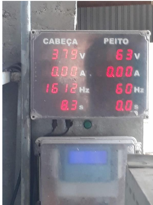
Figura 5. Pannel de choque elétrico.
