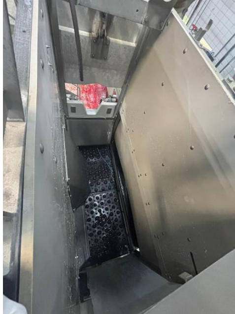
Figura 10. Box com piso antiderrapante, e sistema de contenção.
