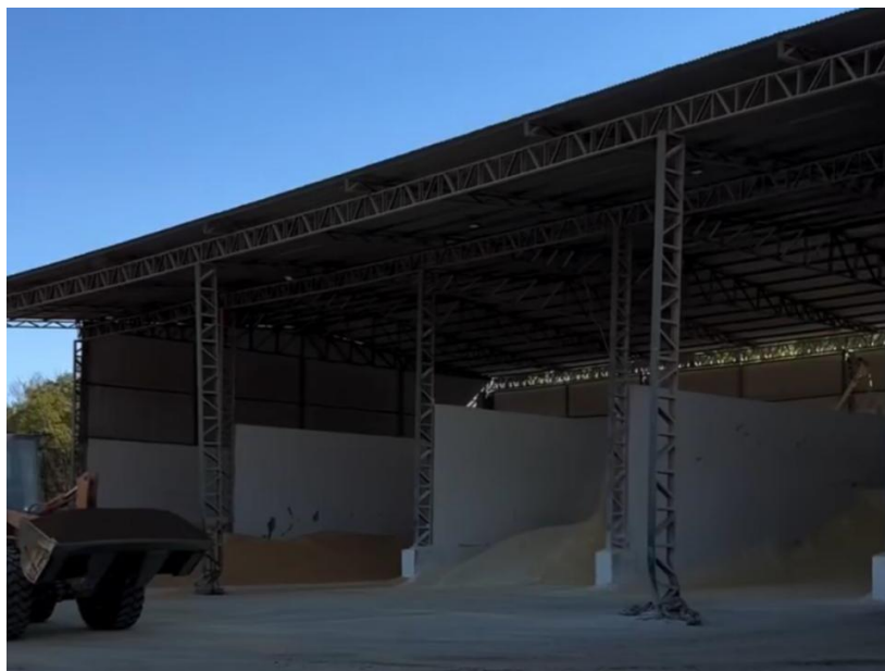
Figura 8- Silo de armazenamento.
